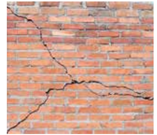
Daños en estructuras
